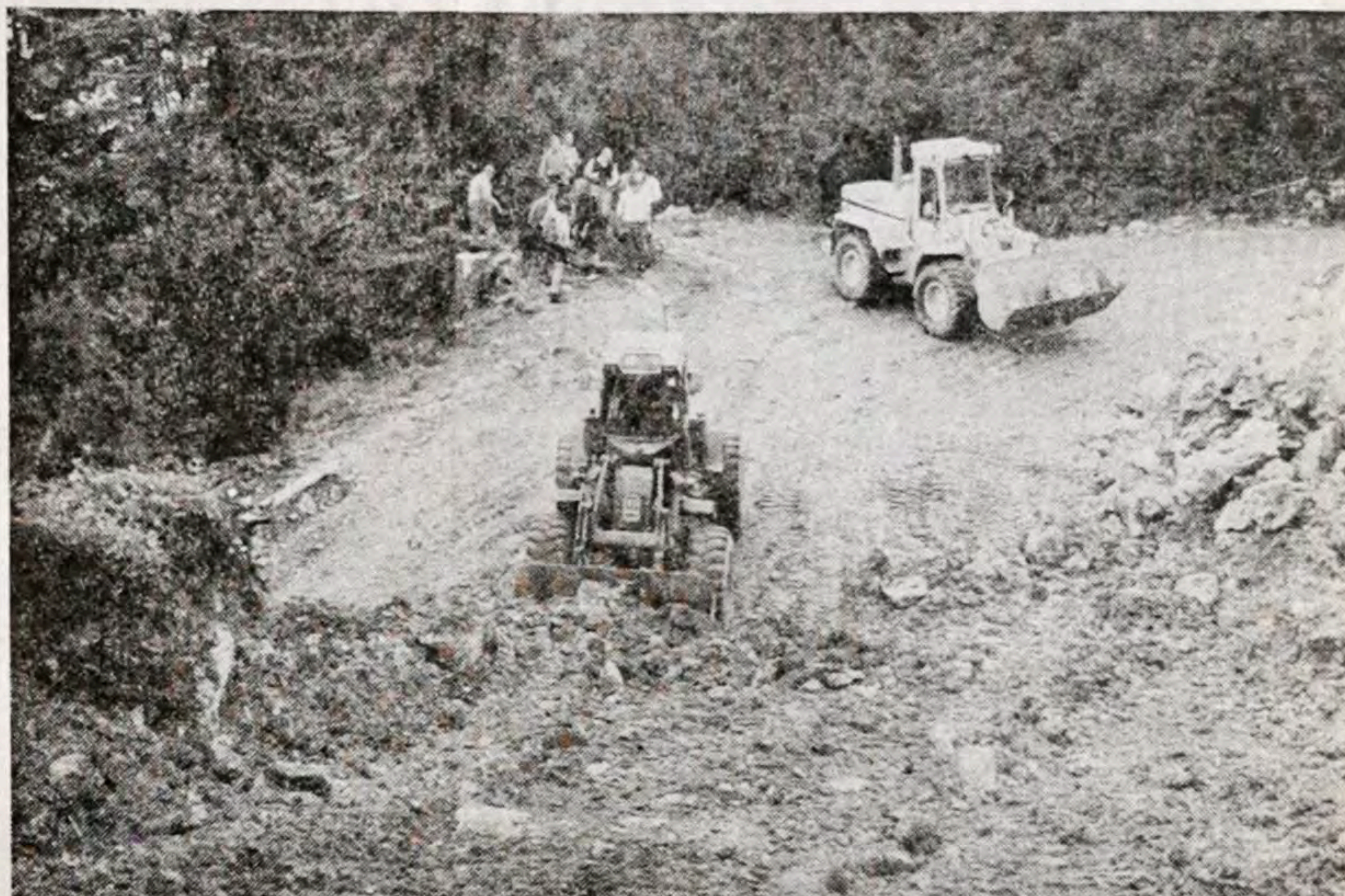
Mit schwerem Gerät sind die Bauleute zwischen Gatterl und Steilhang mit der Verbreiterung und teilweise Verlegung der Garland-Skiabfahrt vom Brauneck beschäftigt. Kümmerle, 2
